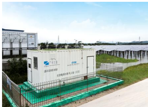
光伏制氢示范项目（江门汶村）
